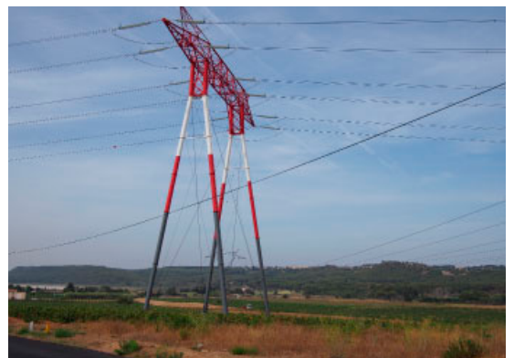
LIGNE THT INTRODUISANT UNE RUPTURE D'ÉCHELLE, PORT-DE-BOUC
