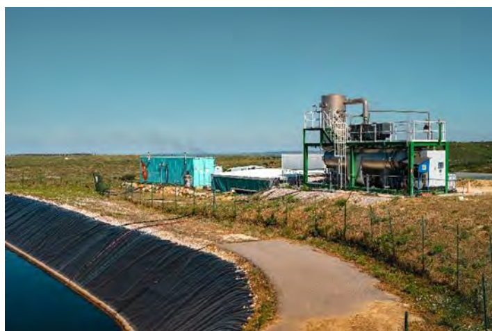
Station de traitement des lixiviats
