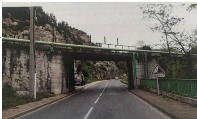
Vue de la canalisation ALTEO au niveau du pont-rail de Roquevaire
