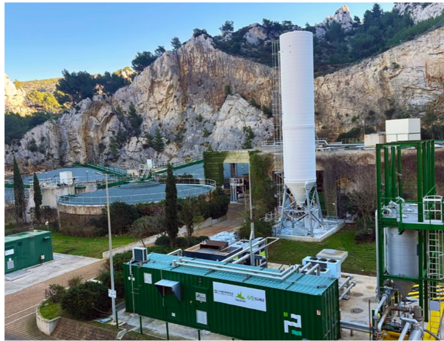
Unité de traitement des boues usées et de production de biométhane de Sormiou, Marseille.
