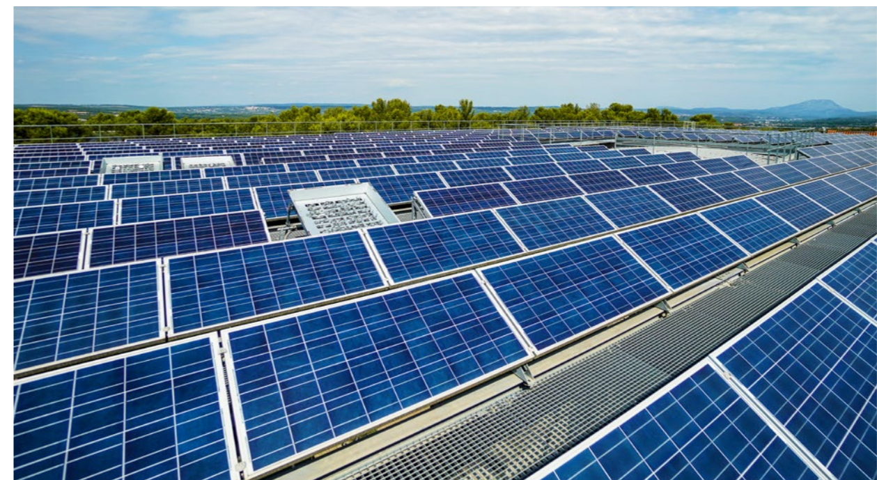
Panneaux photovoltaïques, Arbois-Méditerranée, Aix-en-Provence.
