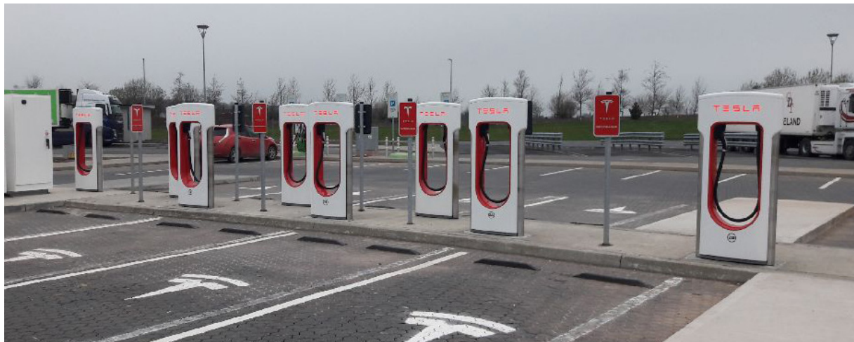
EXEMPLE DE BORNES DE RECHARGE ÉLECTRIQUE SUR AIRE D'AUTOROUTE. Source : Agam
