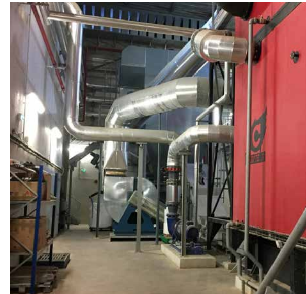
CHAUFFERIE BOIS D'AIX-EN-PROVENCE . Source : M. Lootvoet
